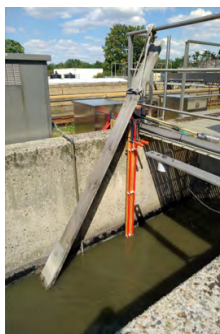
Entnahme von Abwasser am Zulauf der Kläranlage
